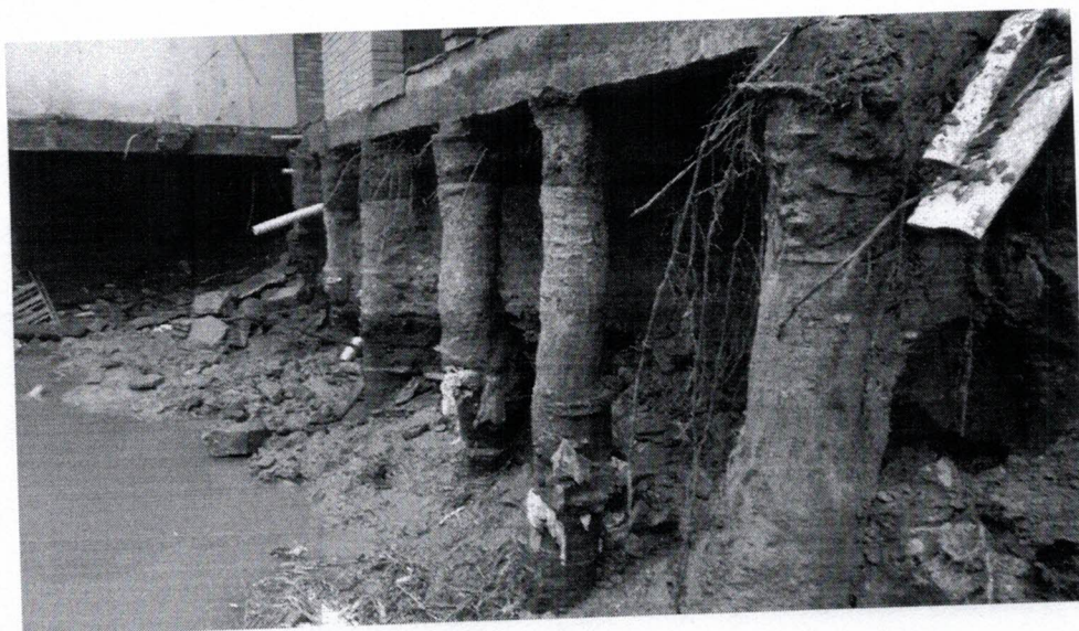
Erosão sob a residência, fundações expostas
